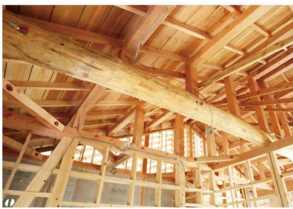
■丸太梁：地元産アカマツの丸太梁は強度と粘りを併せ持ち、たわみづらく家全体を守る。今では稀少な伝統構法による匠の技。
